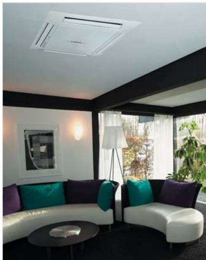
Bild 9: Kassetten-Inneneinheit der Kaltwasser-Klimaanlage Vitoclima 200-C
