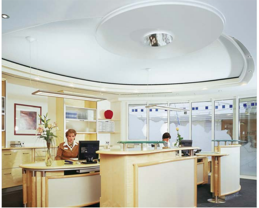
Bild 8: Klimadeckensystem (Bild: Firma EMCO)
